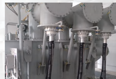
上海电气一号主变项目
