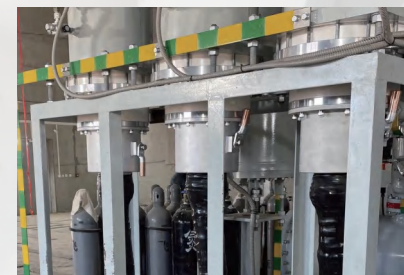
通辽市龙马风能220kV变电站一期
