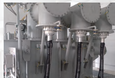
上海电气一号主变项目
