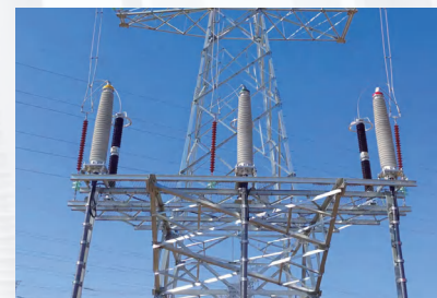
阳高220kV变电站项目
