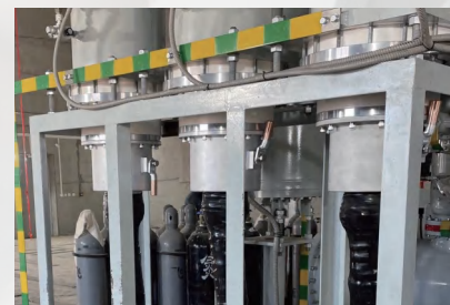
通辽市龙马风能220kV变电站一期
