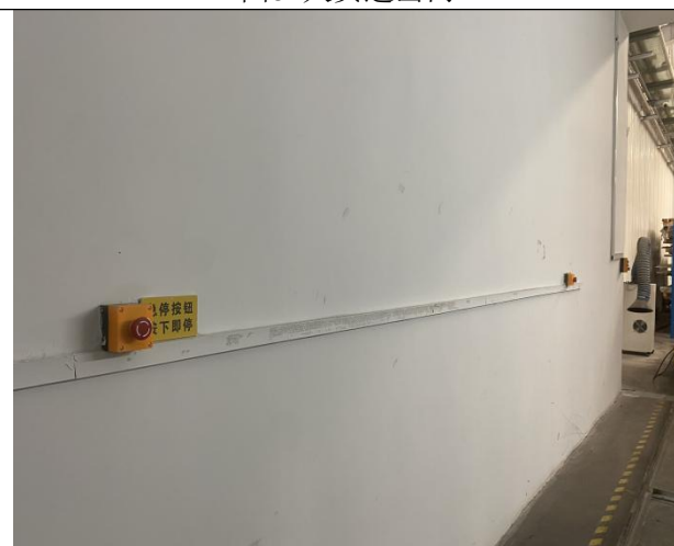
图5 探伤室内急停开关
