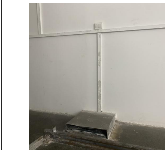
图10 探伤室内排风口
